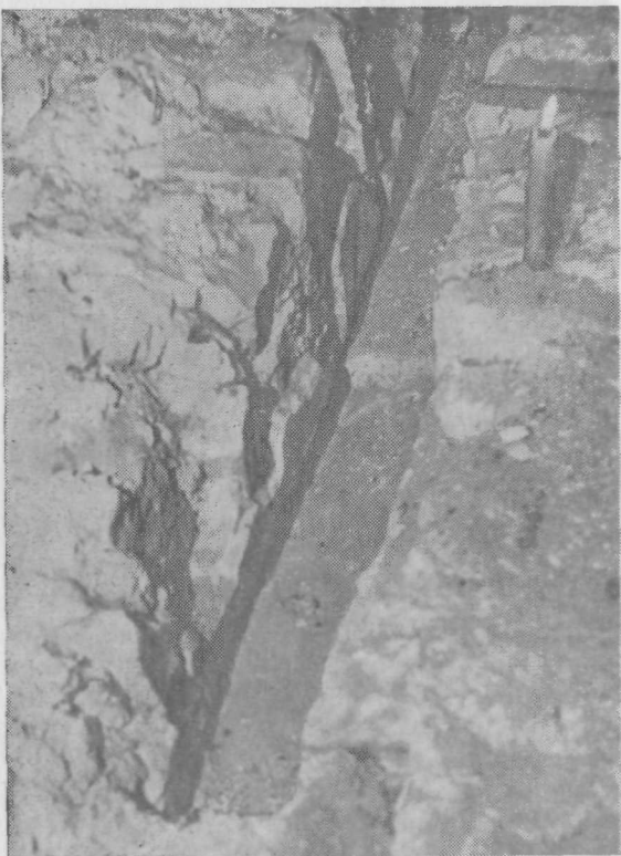
Рис. 1. Трещина-стык (зондаж) в своде западного рукава центрального пространственного креста — месте присоединения свода нартекса
