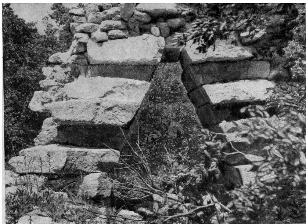
Рис. 5. Ложный свод внутренней камеры башни Горной стены на участке Джалганский хребет — с. Митаги (снимок 1957 г.)
